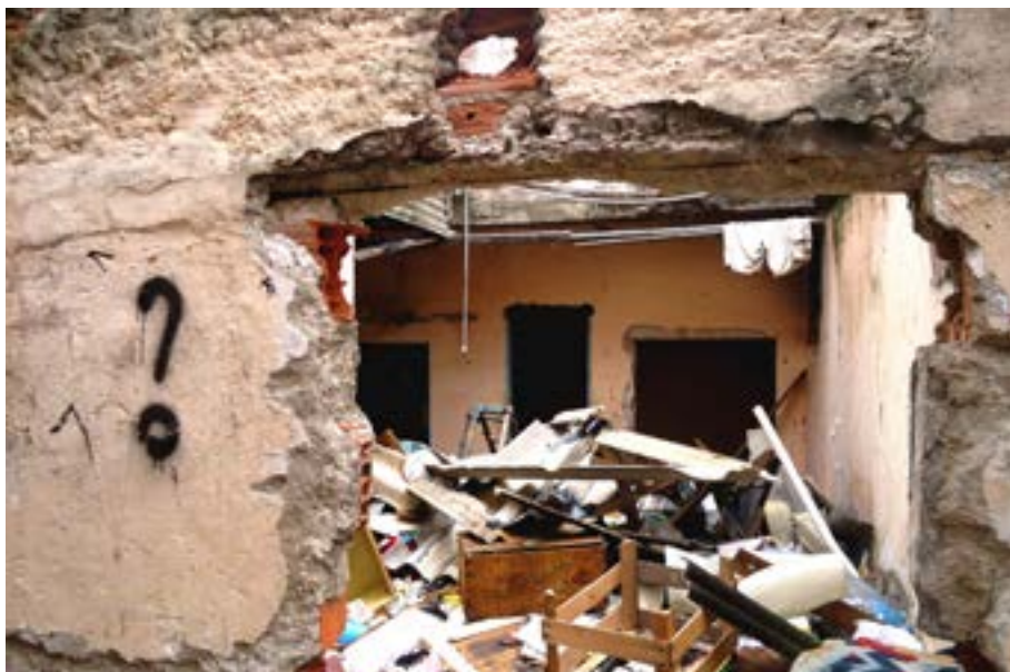
Casa demolida na Favela do Metrô, com os escombros abandonados pela prefeitura
